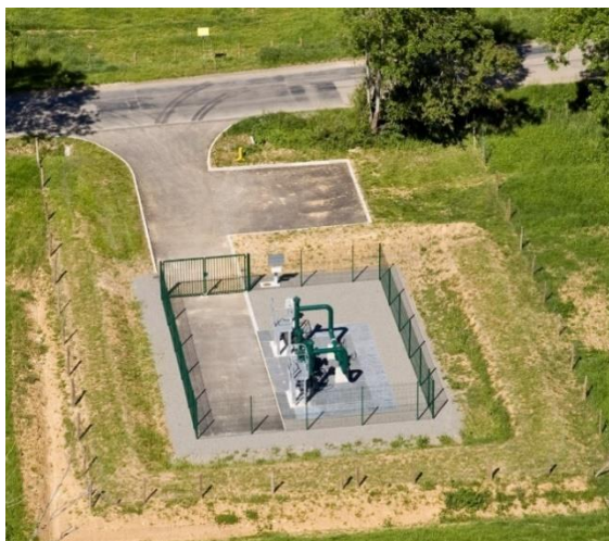
Exemple de poste de livraison de gaz dans son enceinte clôturée
